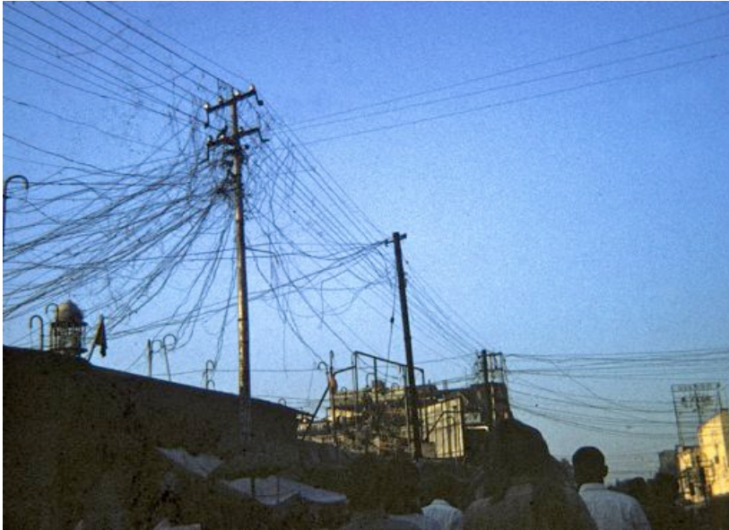
Freileitungsnetz in einem Stadtteil von Dacca
